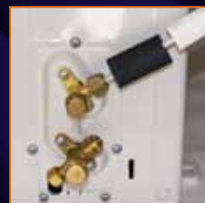
5. Installation du raccord standard (couple de serrage suivant préconisation des fabricants d'unité A/C)
